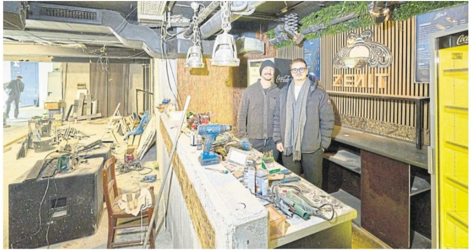
Am Wochenende ist es soweit: Das Zenit in Koblenz öffnet seine Türen nach monatelanger Schließung wieder. Wenige Tage vor der Eröffnung ist der Dancefloor noch eine Baustelle. Fotos: Sascha Ditscher
